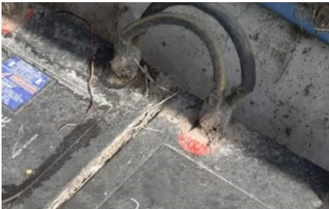
Ilustración 2: Baterías Actuales - Tipo de Bornes
